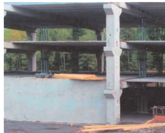
Фото 3. Фрагмент каркаса автостоянки до выполнения верхнего монолитного слоя перекрытия. Видны временные инвентарные стойки, которые демонтируются после достижения требуемой прочности бетона.
