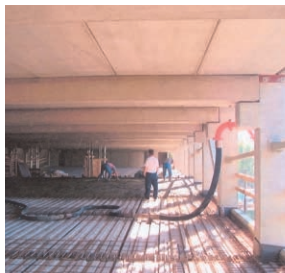
Фото 6. Устройство верхнего монолитного слоя плиты перекрытия по ранее установленным нижним (опалубочным) плитам.
