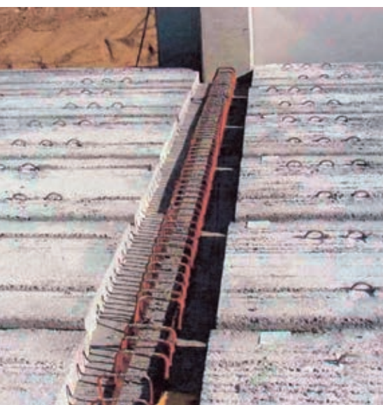
Фото 4. Узел сопряжения большепролетной балки и нижних плит перекрытия до выполнения верхнего армирования и укладки монолитного слоя.
